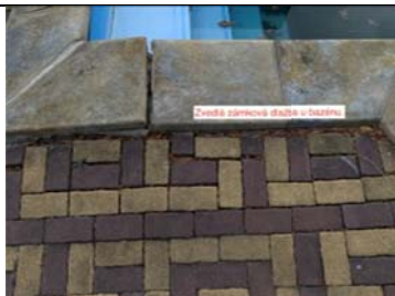
Zvedlá zámková dlažba okolo bazénu
