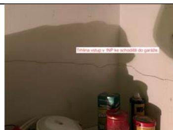
Trhlina u vstupu 1.NP ke schodišti do garáže
