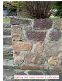
Prasklina v opěrné zdi
