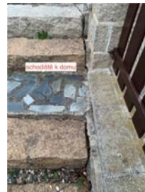
Prasklina na schodišti k domu
