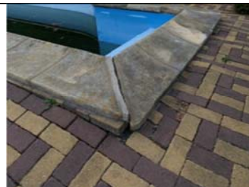
Zvedlá zámková dlažba okolo bazénu
