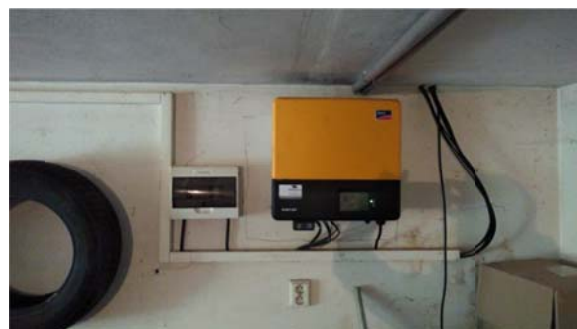
FVE – vnitřní jednotka v garáži
