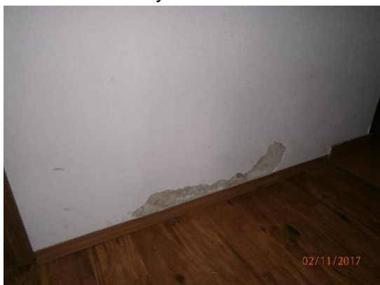
Poškození omítky v 1.NP
